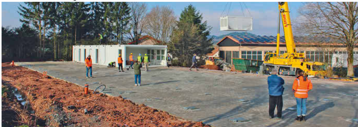
Am Dienstag und Mittwoch erfolgte die Aufstellung der 47 Container / Foto: Gemeinde Nohfelden
